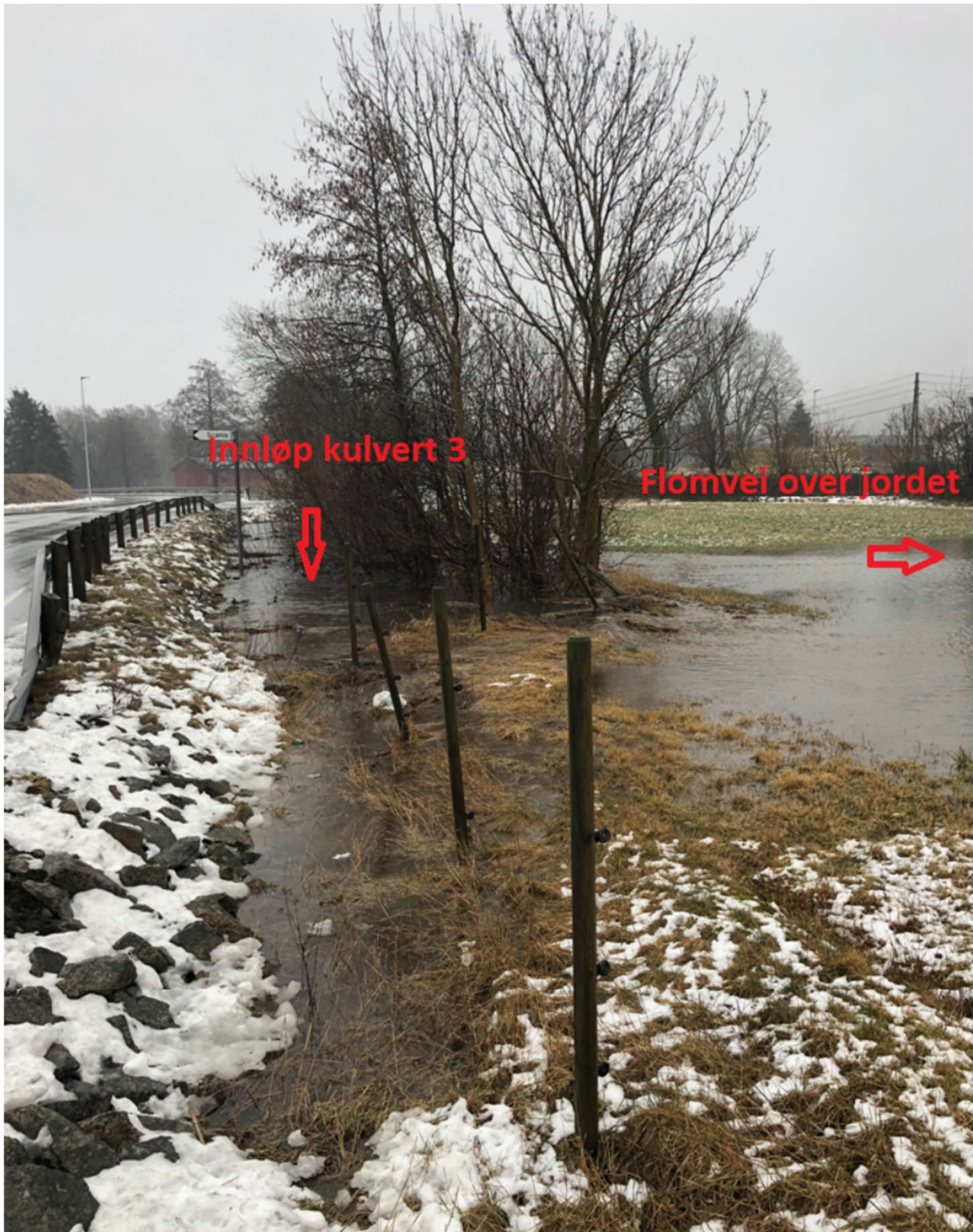
Figur 6. Innløpet av kulvert 3 dykket. Overløp/flom utover det kulvert 3 ikke kan ta hånd om.
